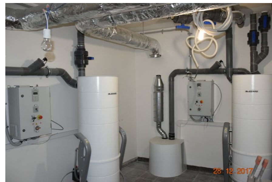
< Помещение с силовыми блоками для уборки сцены. 2017 год.
